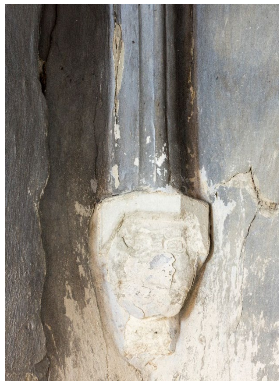
Detail severozápadní konzole přízemí věže. Foto: Marta Pavlíková, 2018.
