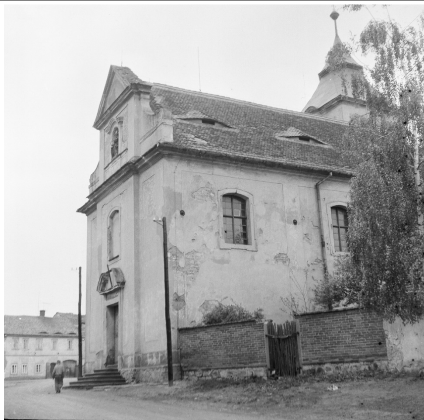
Pohled od jihozápadu. Foto: 1963, sbírka negativů NPÚ ÚOP v Ústí n. L., sign. 8718.
