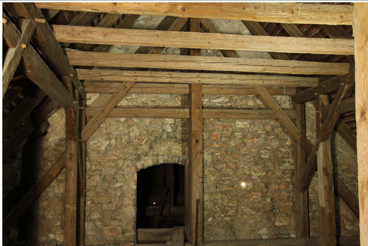
Krov nad lodí v pohledu od západu směrem ke štítu mezi presbytářem a lodí. Foto: Jaroslav Skopec, 2018.
